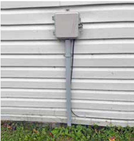
↑ La boîte pour le service de fibre optique à l'extérieur de la maison. Photo : Courtoisie
